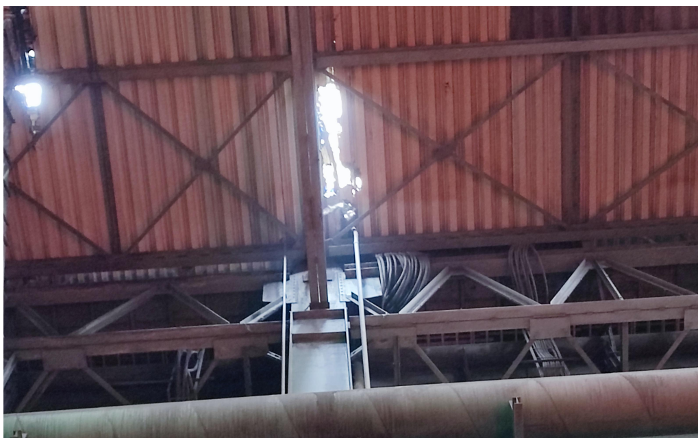
图 2-2 屋面坍塌洞口（仰视）
