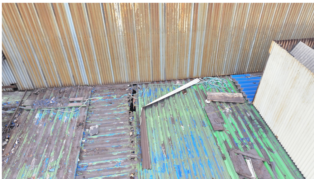
图 2-1 屋面坍塌洞口（俯视）
